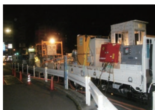
車上式注入プラント
