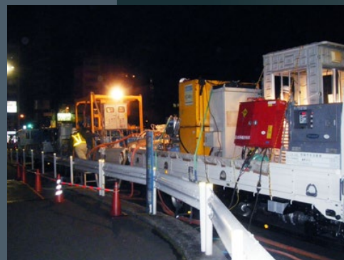
車上式注入プラント
