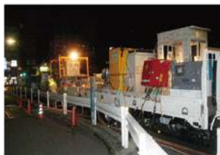
車上式注入プラント
