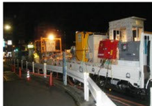
車上式注入プラント
